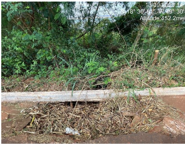
c. Sarjeta perfurada pela força da água pluvial em ponto baixo da avenida Treze (entre as ruas Quatro e Dois)
