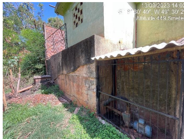
(g) Bomba afogada da EEB-2
