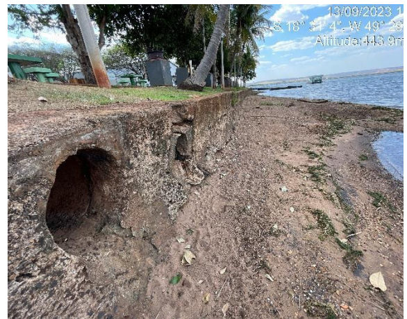
d. Exutórios subterrâneos paralelos da água pluvial coletada nas bocas-de-lobo dos cruzamentos da rua Quatorze com avenida Cinco, BR-154 e avenida da Praia
