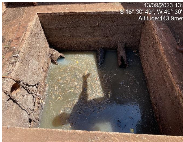
b. Poço de entrada da EEB-2 e gradeamento
