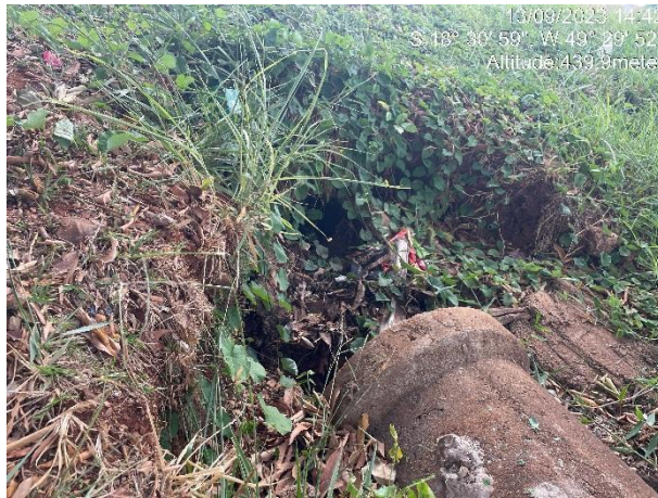
a. Exutório subterrâneo da água pluvial coletada nas bocas-de-lobo dos cruzamentos da rua Dez A com a BR-154 e avenida Um
