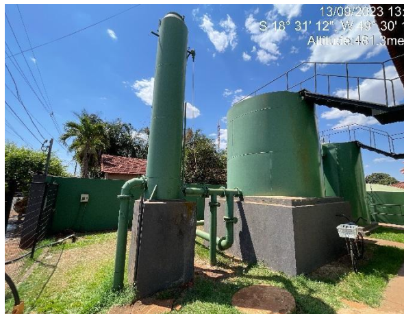
a. Entrada da adutora de água bruta na câmara de carga (em primeiro plano) e filtros (segundo plano)
