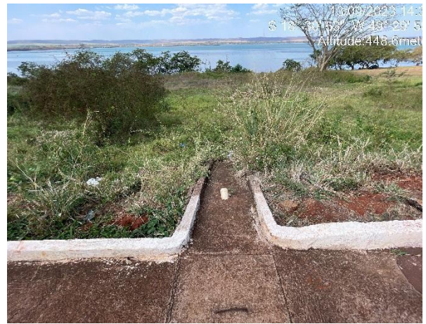
d. Exutório superficial na avenida Treze (entre as ruas Quatro e Dois)
