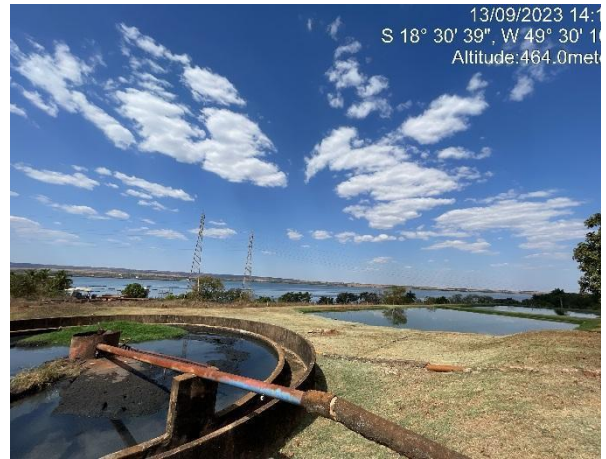
Reator UASB (em primeiro plano) e lagoas de estabilização (ao fundo)
