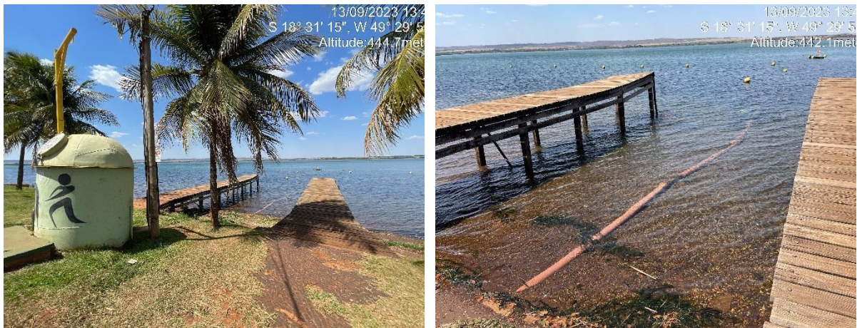
Figura 26. Sistema de captação no rio Paranaíba. Situação em setembro de 2023
