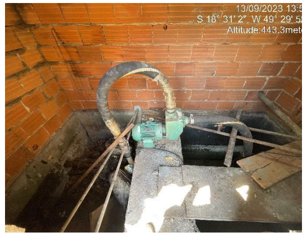
e (b) Diferentes perspectivas da bomba não afogada e poço de sucção da EEB-1
