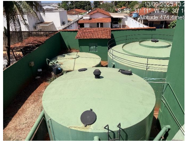
(d) Tanque de contato (em primeiro plano), reservatório de retrolavagem (ao fundo à esquerda) e reservatório de água tratada (ao fundo à direita), que opera como poço de sucção da EAT
