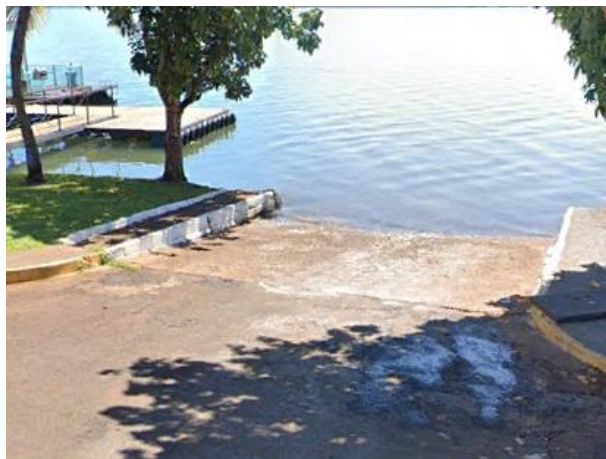
c. Rampa náutica e exutório superficial na avenida da Praia, em frente à rua “sem nome” (localizada entre as ruas Dez A e Quatorze)
