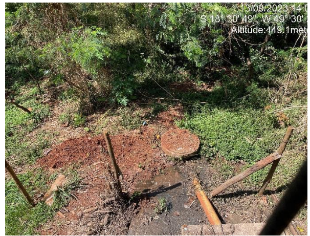
e. Tubulação de saída da EEB-2
