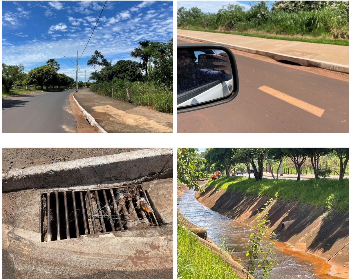
Figura 57. Sarjetas e bocas de lobo em A) arruamento marginal ao córrego Maria Elias e B) em novo pavimento; C) boca de lobo em bom estado de conservação, porém com acúmulo de resíduos sólidos em seu gradeamento; D) lançamentos finais da galeria de água pluvial no canal artificial do córrego Maria Elias
