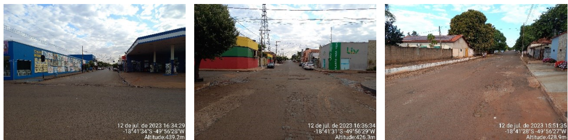
Figura 79. Registro fotográfico dos maiores problemas no sistema de drenagem pluvial: (a) Alagamentos; (b) processo erosivo da pavimentação.
