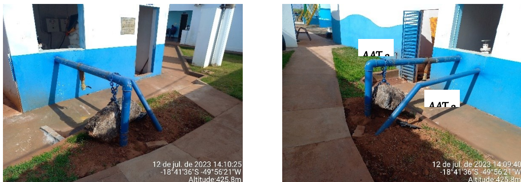
Figura 40. Registro fotográfico das adutoras AAT-2 e AAT-3
