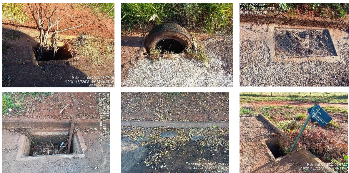
Figura 93 - . Problemas com a funcionalidade e capacidade de engolimento das bocas-de-lobo.
