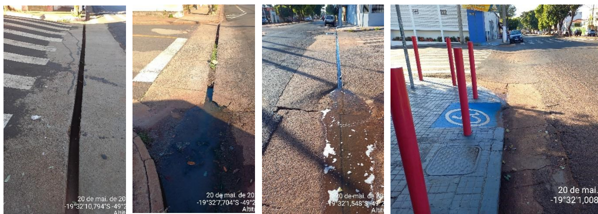
Figura 91 - Sarjetões na área urbana de Campina Verde. Fonte: Autores (2023)
