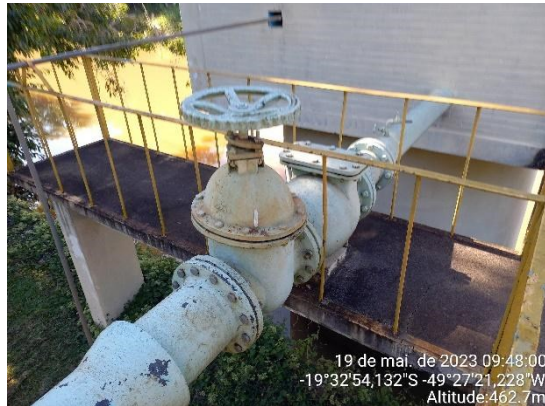
Figura 27 - Adutora de Água Bruta (AAB).
