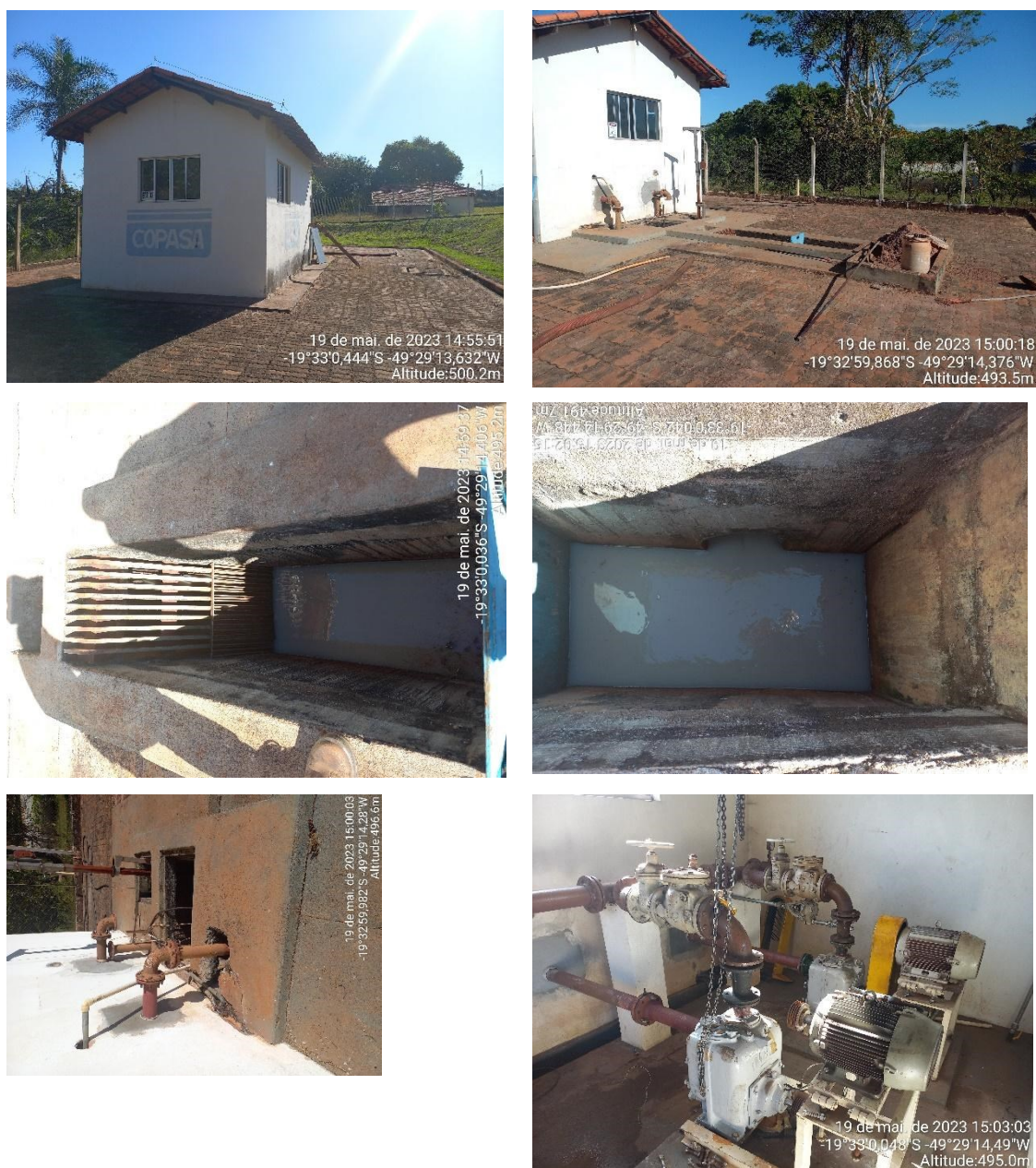
Figura 44 - Registro fotográfico das instalações na EEB-1
