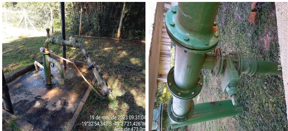
Figura 23 - Poço tubular profundo P-01 localizado nas proximidades da captação superficial.
