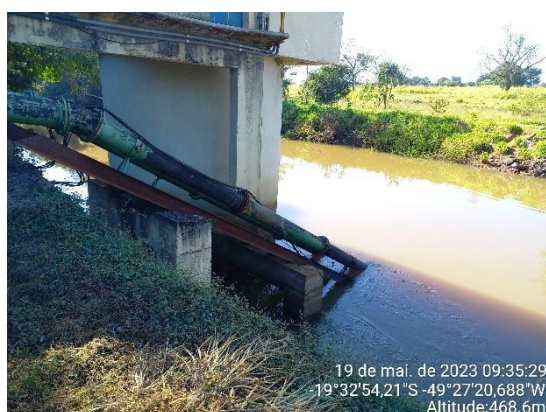
Figura 24 - Elevatórias de Água Bruta (EAB).
