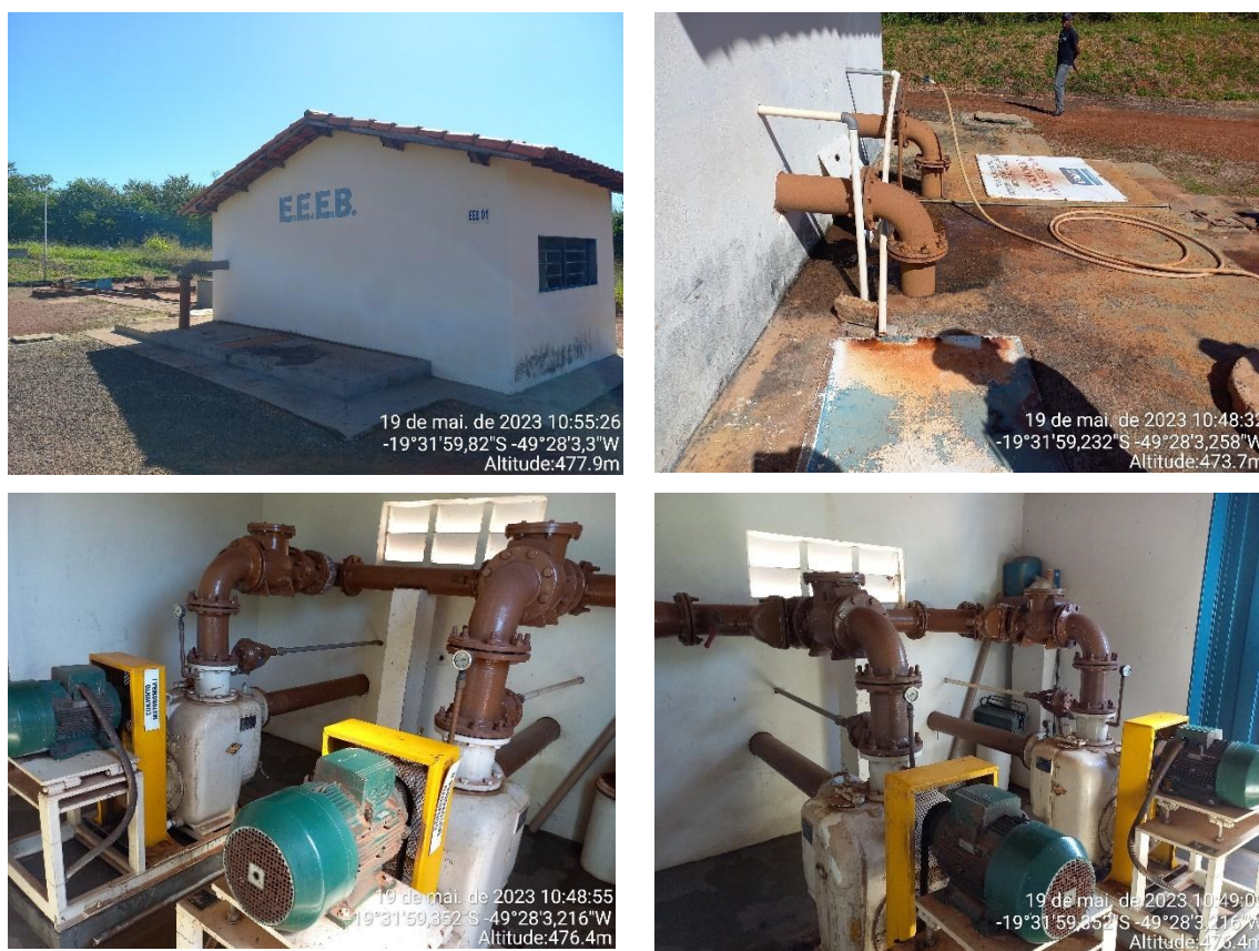
Figura 47 - Registro fotográfico das instalações na EEB-2.
