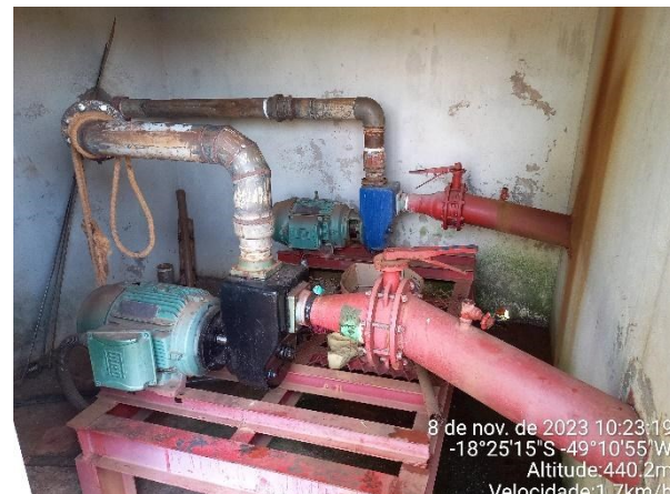
(d) Detalhe dos dois conjuntos motobombas em paralelo na EEB-1
