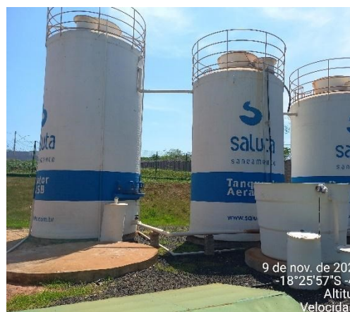
(f) Reatores UASB, tanque de aeração e decantador secundário, em série.
