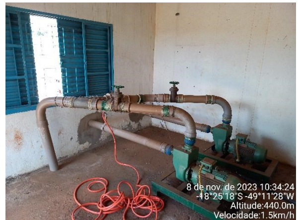
(f) Detalhe dos dois conjuntos motobombas em paralelo na EEB-2
