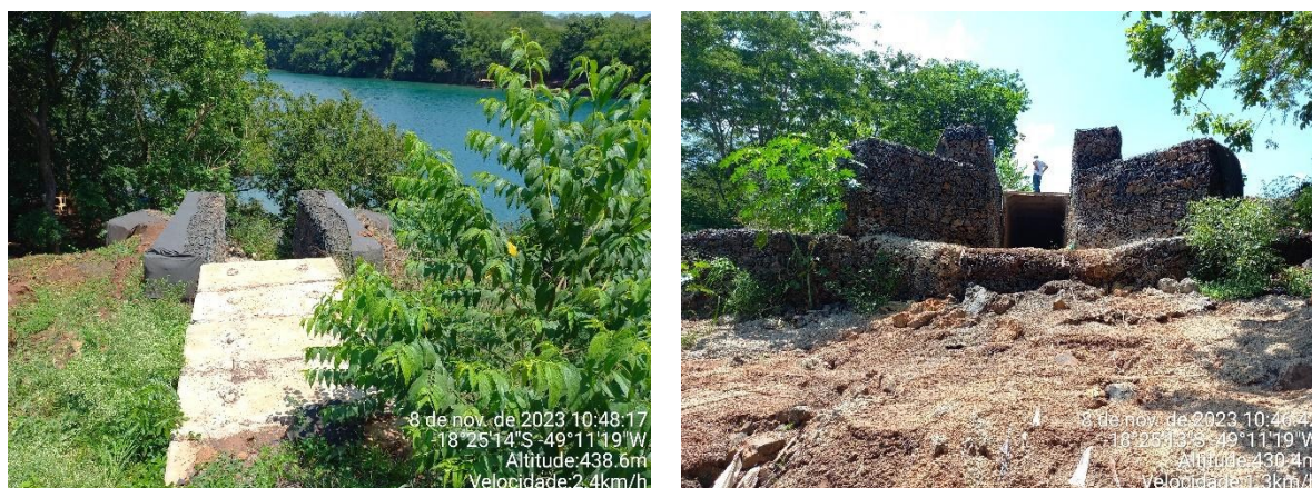
(c) Dissipador de energia no exutório da galeria pluvial no bairro Liberdade
