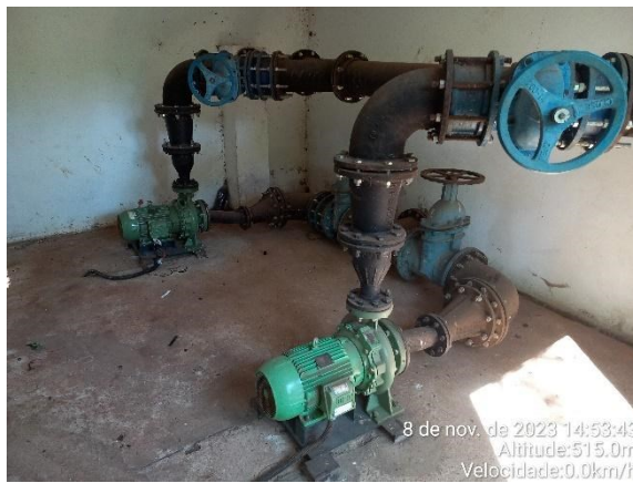
(a) Conjuntos motor-bombas
