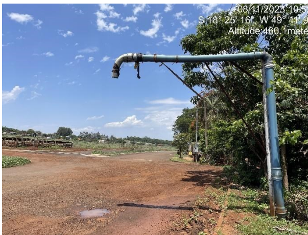
(a) Ponto de alimentação de caminhão pipa
