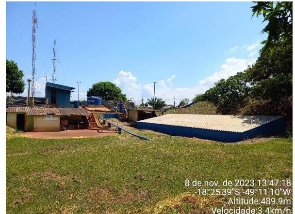
(f) Tanques de contato (circular enterrado e retangular semi-enterrado)
