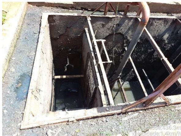
(c) Detalhe de transbordamento no poço de sucção da EEB-1
