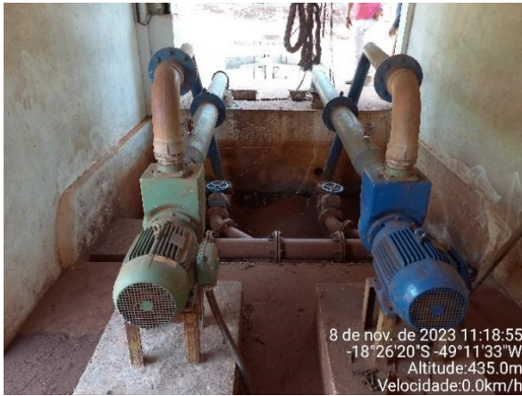
(e) Sistema elevatório
