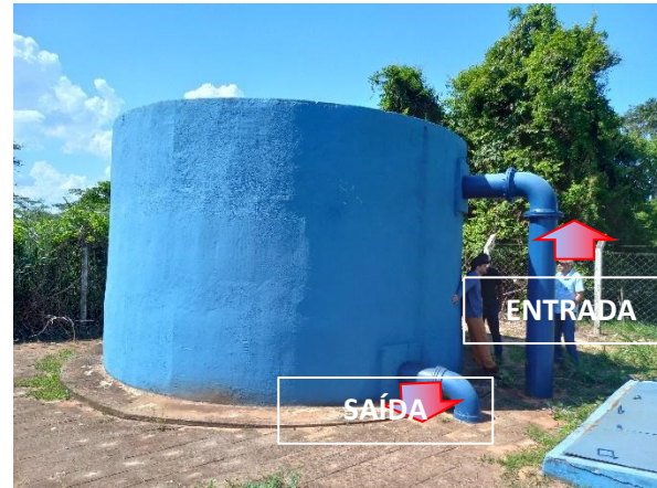
(b) Detalhes das tubulações de entrada e saída no reservatório de transição
