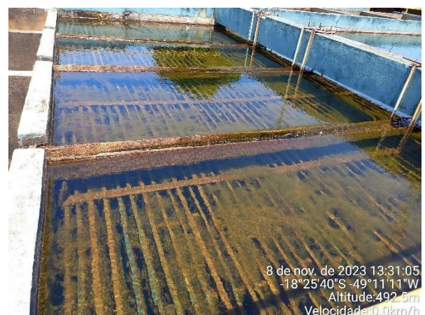
(d) Lamelas, similares a colmeias de abelha, instaladas na metade superior dos tanques apenas na porção longitudinal final do decantador
