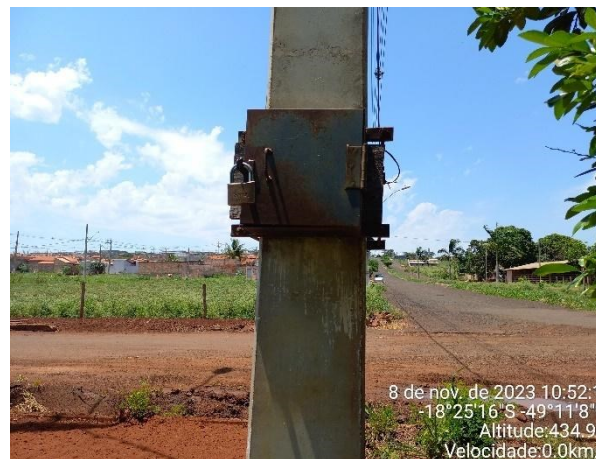
(b) Quadro de comando liga-desliga com cadeado da linha adutora de alimentação de caminhão pipa
