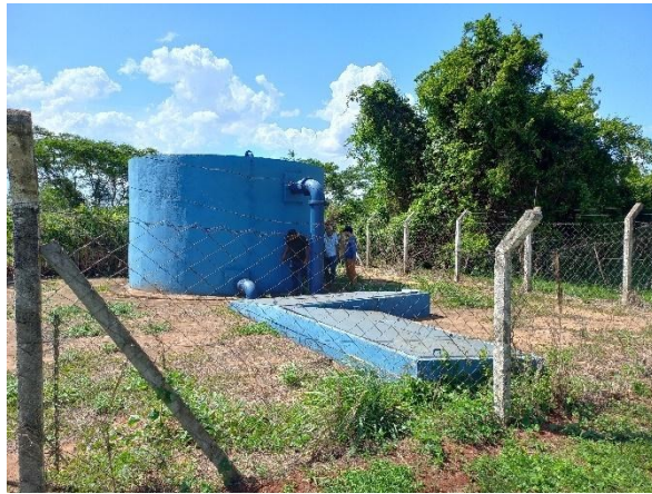
(a) Reservatório de transição com capacidade de 38 m 3
