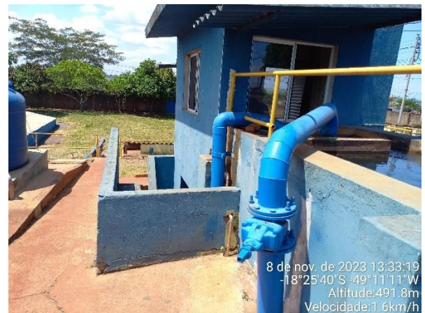
(b) Entrada da adutora do Sistema flutuante no tanque de mistura rápida
