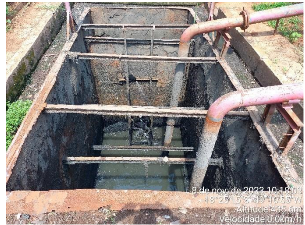
(b) Detalhe do poço de sucção da EEB-1
