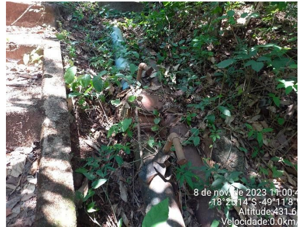
(d) Detalhes da transição entre dutos de ferro fundido dúctil (fofo) e PVC (defofo), além de uma válvula de retenção desprotegida
