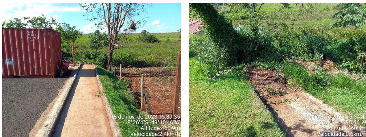
Figura 47. Alguns novos exutórios da rede de drenagem pluvial na área urbana de Araporã/MG
