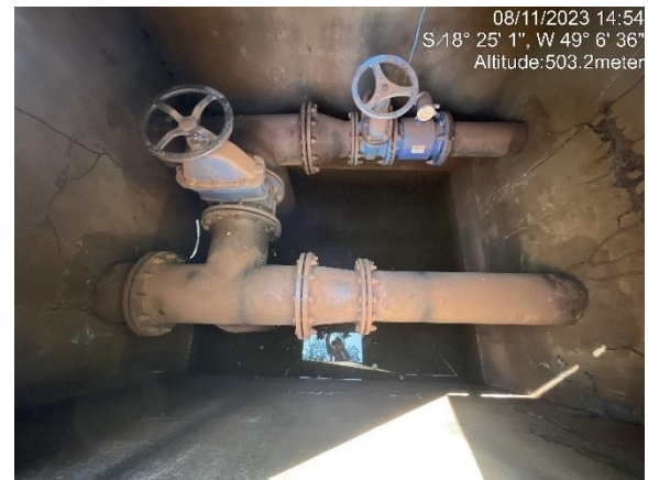
(b) Tubulações de entrada e saída na EAB-1
